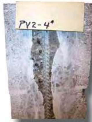
Vista en corte de un relleno de bloques ejemplificando los resultados de la técnica vibratoria incorrecta.
